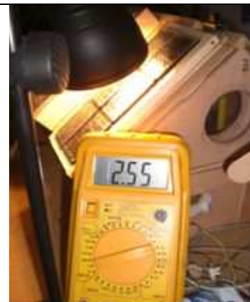
Medición con el polímetro, de la energía eléctrica real proporcionada por la central solar fotovoltaica. 2,55 V.
