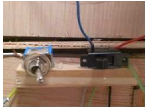
Montaje del circuito eléctrico que controla el sistema híbrido de generación de energía eléctrica.
