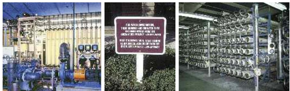
Izquierda: planta piloto de microfiltración previa a la ósmosis inversa, como pretratamiento de ésta. Centro: cartel indicador de uso de agua regenerada. Derecha: batidores OI de una unidad de tratamientos terciarios para ósmosis inversa que regenera agua para darle calidad de agua potable e inyectarla en el acuífero. Así se protege a éste de intrusiones marinas y se recarga el acuífero para usos potables. California, EEUU.
