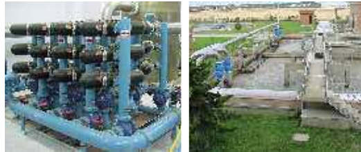
Izquierda: tratamiento terciario de filtración por anillas. Derecha: tratamiento biológico con nitrificación-desnitrificación. EDAR El Torno, Chiclana de la Frontera, Cádiz.
